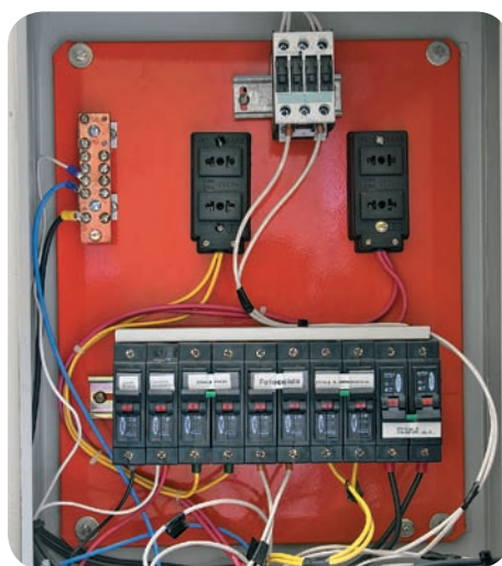
Disjuntores no quadro de luz de uma casa.
